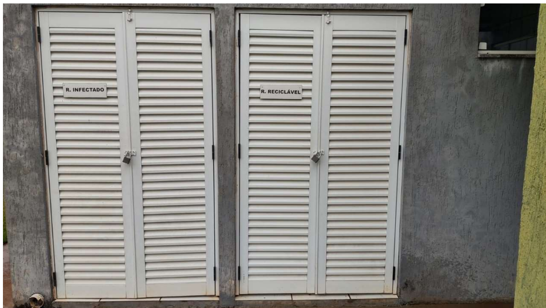
Figura 40 - Edificação específica de armazenamento temporário de resíduos dos serviços de saúde da UBS São Sebastião do município de Vera Cruz do Oeste/PR
